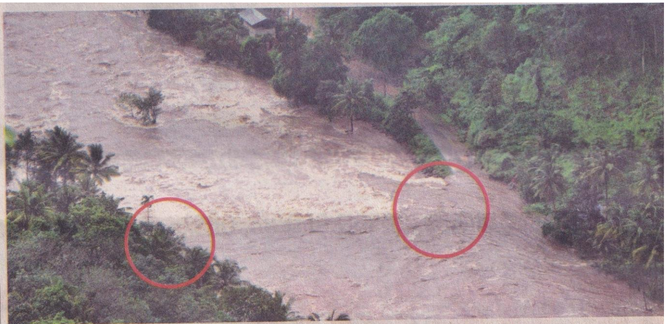
ചെറുതോണി ഡാം തുറന്നു വിട്ടപ്പോഴുണ്ടായ വെള്ളപ്പാച്ചിലിൽ തകർന്ന പെരിയാർവാലിയിലെ ചപ്പാത്ത്. കഞ്ഞിക്കുഴി-വാത്തിക്കുടി പഞ്ചായത്തുകളെ ബന്ധിപ്പിക്കുന്ന 30 വർഷം പഴക്കമുള്ള ഈ ചപ്പാത്ത് തകർന്നതായാണു പഞ്ചായത്ത് അവലോകന സമിതിയോഗം ഇന്നലെ വിലയിരുത്തിയത്. ചപ്പാത്ത് നു ബലക്ഷയമുണ്ടായിരുന്നതായി പറയപ്പെടുന്നു. വൃത്തത്തിൽ കാണുന്ന ഭാഗങ്ങളിൽ വീള്ളലുണ്ടായെന്നാണു ജനങ്ങളുടെ ഭീതി. -ബിബിൾ സേവ്യർ
